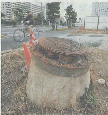
液状化で突き出したマンホール。南海トラフ地震では都心も広範囲で液状化に見舞われ、交通網への影響が懸念される
